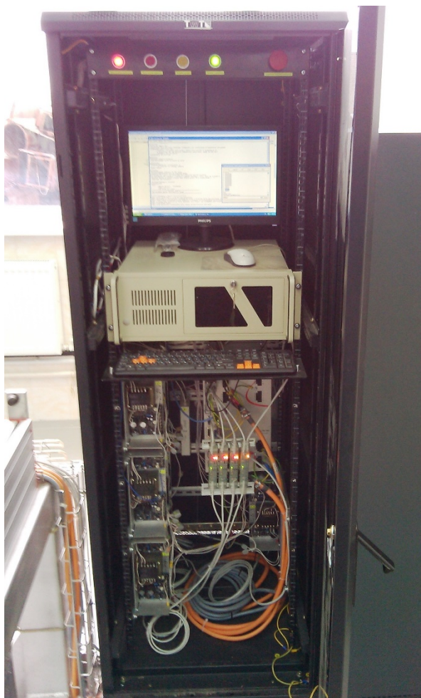
Рисунок 1 – Шкаф приводов с открытой дверью (панель, закрывающая блоки, снята)
